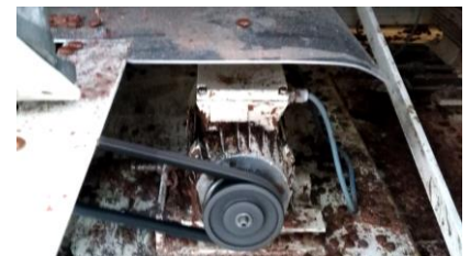
Figura 65: Chapa metálica sobre os motores
