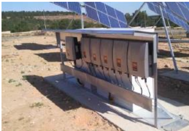
Figura 3.33 - Representação inversores instalados no exterior, protegidos da exposição direta do sol, referência [15].
