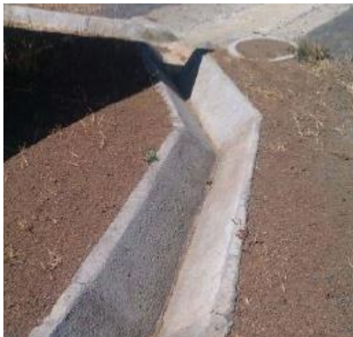
Figura 3.11 - Representação de vala de escoamento limpa e desobstruída, referência [15].
