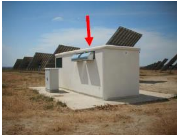
Figura 3.32 - Representação de condutas de ventilação num edifício que abriga os inversores, referência [15].
