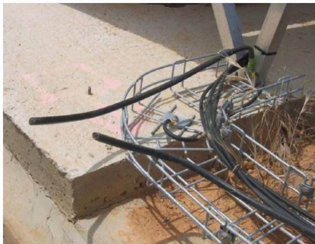
Figura 3.19 - Representação de uma má prática, onde foi cortado o fio errado por falta de identificação, referência [15].
