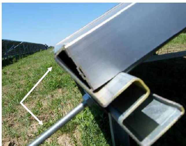
Figura 3.20 - Representação de uma estrutura de suporte com um mau encaixe nos caixilhos de estrutura, referência [15].
