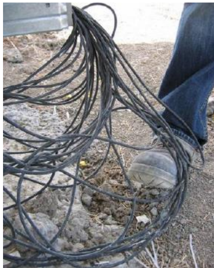
Figura 3.14 - Representação de uma má prática, quando os cabos não estão protegidos em calhas, onde as entradas de água estão seladas, referência [15].
