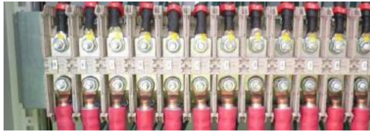
Figura 3.27- Representação de cabos conectores devidamente cravados e parafusados, referência [15].
