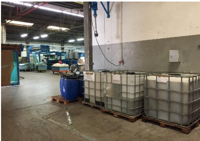
Figura 44 - Novo local dos tanques de produtos químicos utilizados nas râmolas
