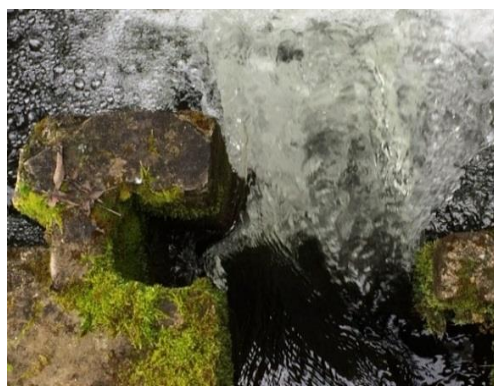
Fig. 49 - Perturbação do escoamento no descarregador lateral devido à existência de ranhuras
