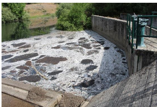
Fig. 58 - Presença de detritos junto às aberturas de admissão de caudal
