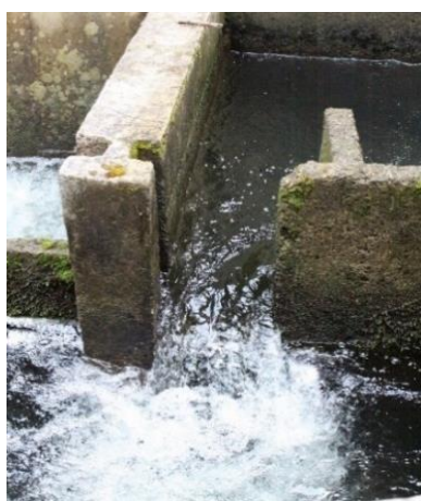
Fig. 50 - Queda de água desafoçada
