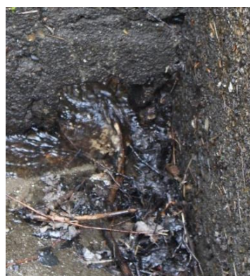
Fig. 40 - Orifício de fundo obstruído
