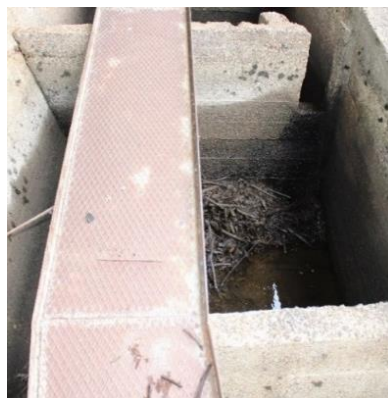
Fig. 41 - Acumulação de detritos no fundo das bacias
