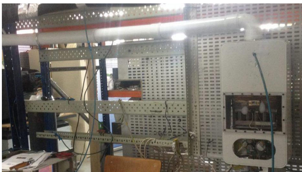
Figura 5.14 - Fotografia do esquentador com a instalação de uma conduta que induz uma perda de carga correspondente a 4 metros.
