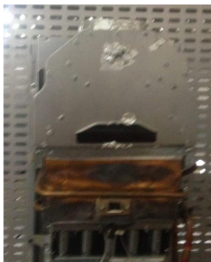
Figura 5.4-Fotografia da fixação do injetor na chaminé standard.
