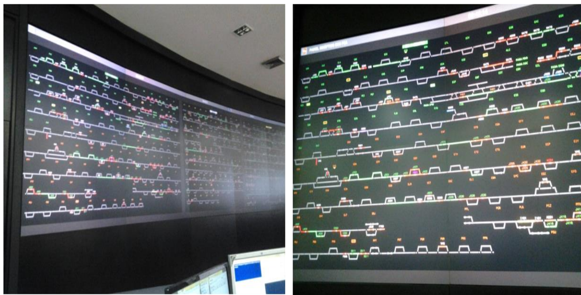
Figura 5 – Painel sinóptico supervisão circulação
