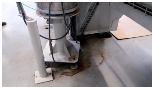
Figura 8-Sujidade na área de trabalho (colagem)
