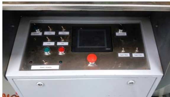
Figura 49-Marcação do painel das máquinas de colar
