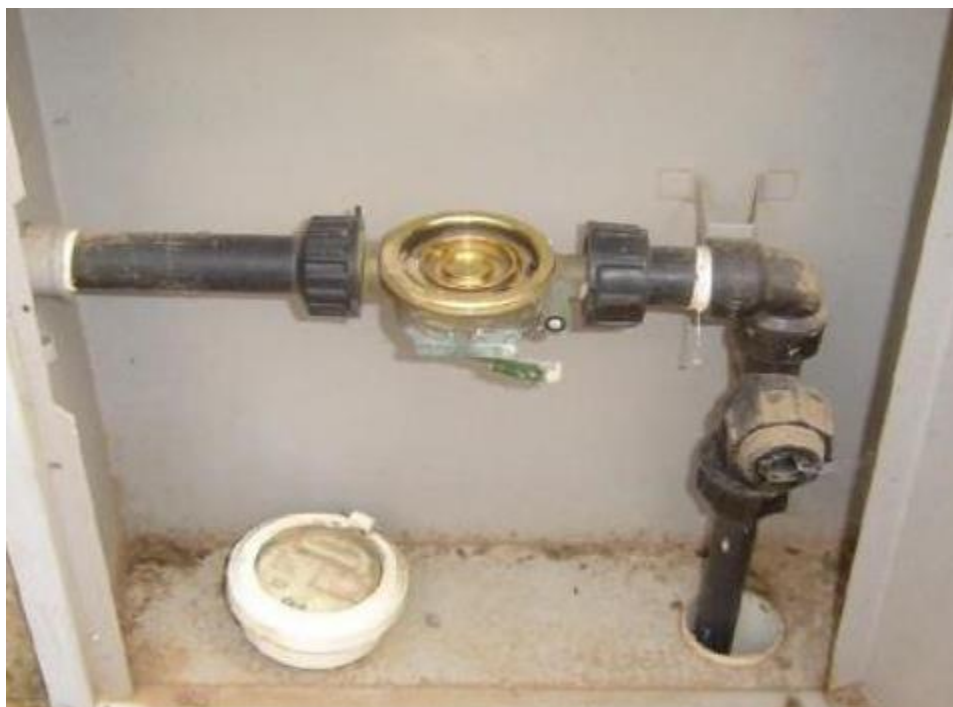
Figura 2.21: Violação do selo do contador e quebra do vidro (Pereira, 2007)
