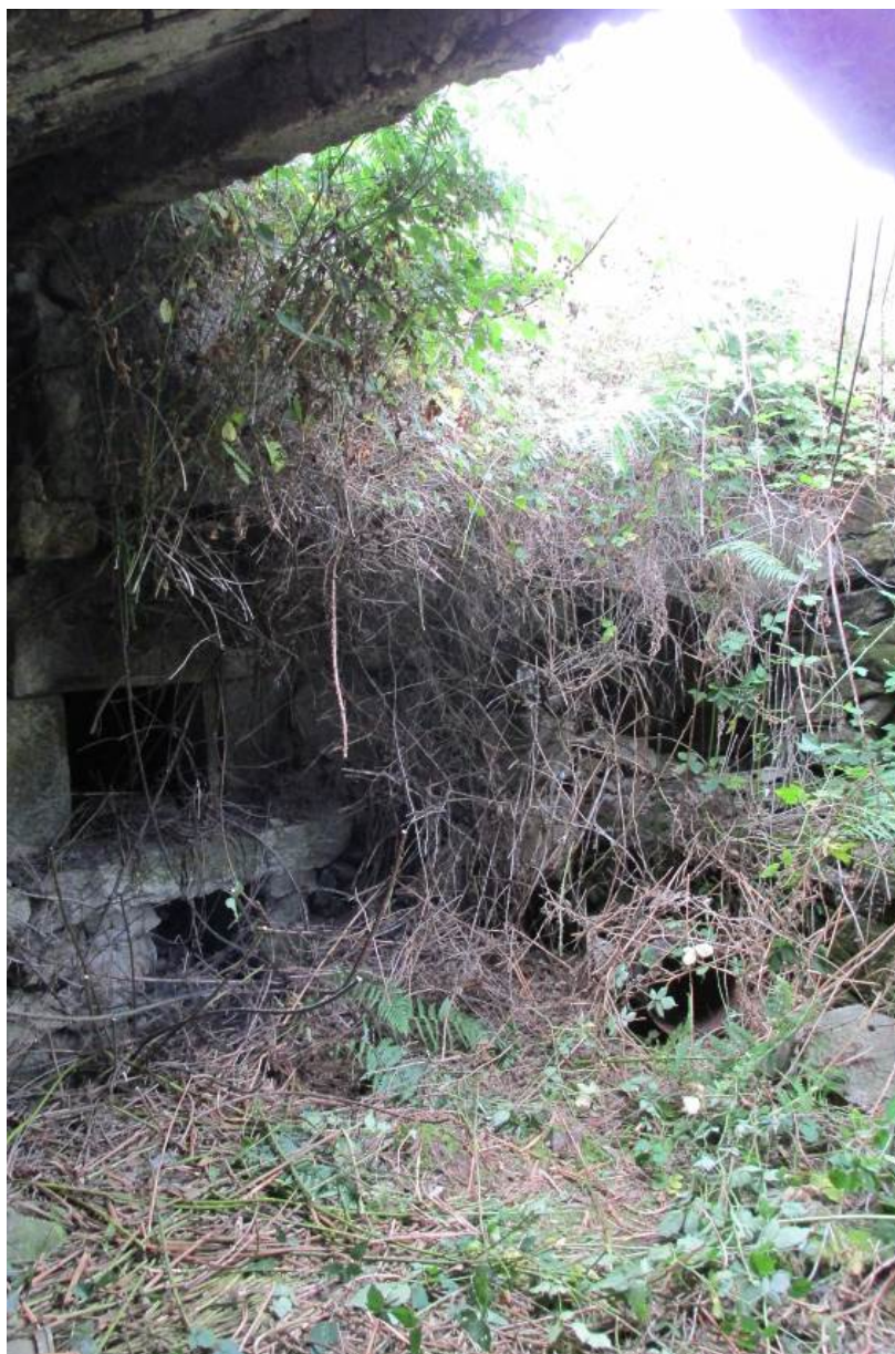
Fig. 62 – Forno do Lugar do Teso (branda). Interior. Cobertura arruinada. 2015
