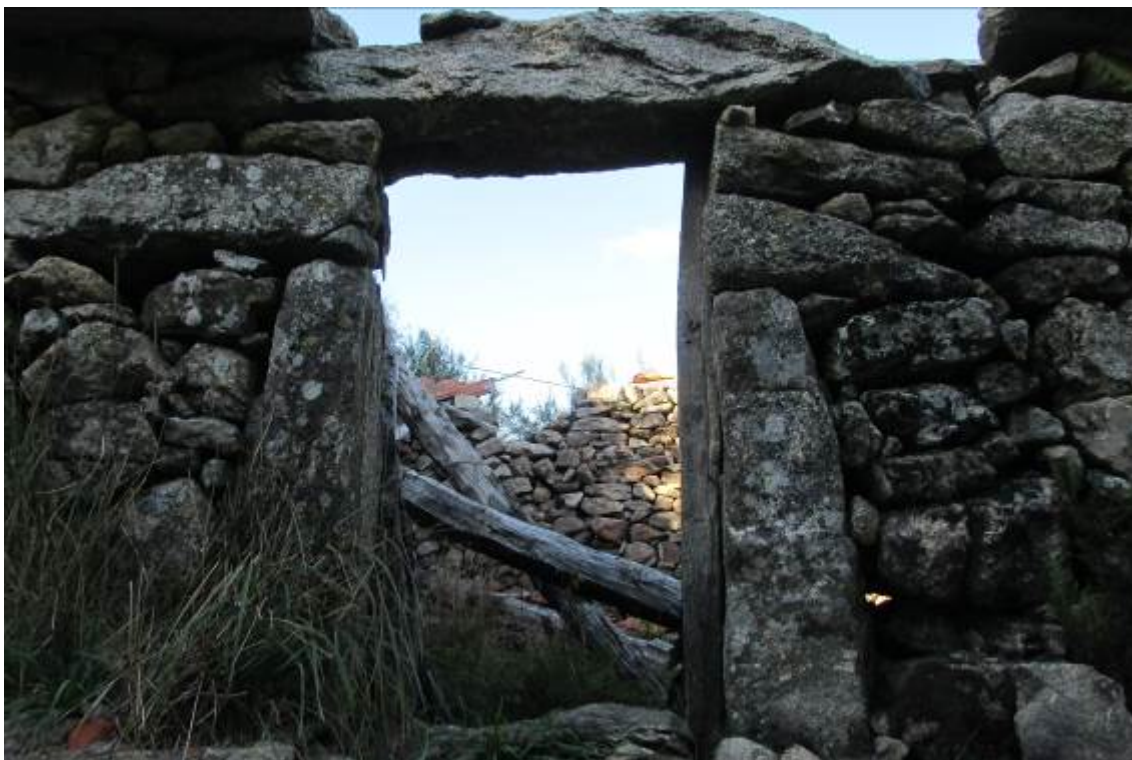
Fig. 60 – Forno nº2 do Lugar de Portos (branda). Vista Sudoeste. Estrutura arruinada. 2014
