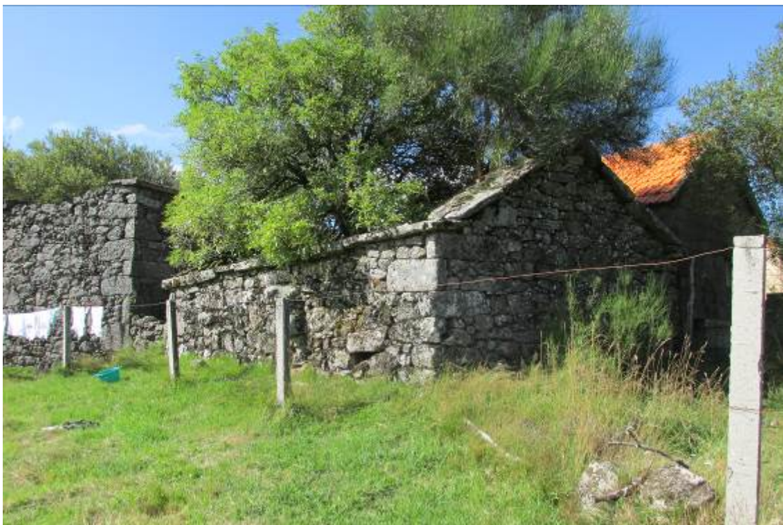
Fig. 57 – Forno do Lugar de Adofreire (branda). Vista Sul. Cobertura totalmente arruinada. 2014
