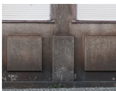
151. Sujidade/fuligem na cantaria do soko
