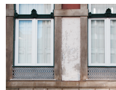
148. Parcial ausência do reboco
