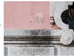
156. Escamação, empolamento e destacamento
