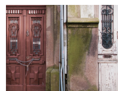
150. Colonização biológica decorrente do tubo de queda de água
