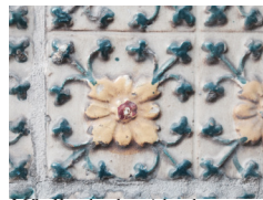
160. Perda do vidrado elementos cerâmicos
