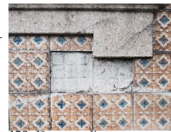
158. Desprendimento e fendilhação de elementos cerâmicos
