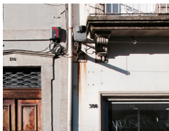
159. Escorrimentos devido a corrosão metálica
