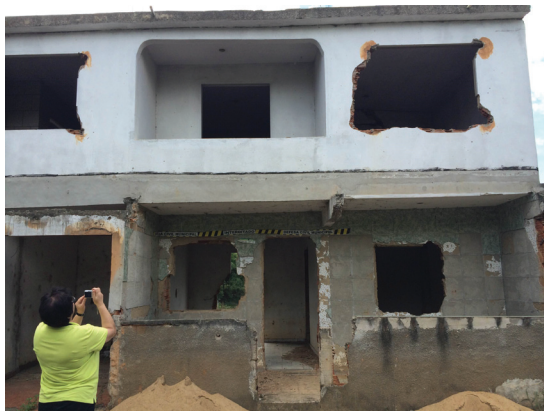
Fot. 4 - Residência interdita pela Defesa Civil por conta dos efeitos da inundação de janeiro/2012 na área urbana de Cardoso Moreira (Fotografia de Raul Reis Amorim, abril de 2015).
