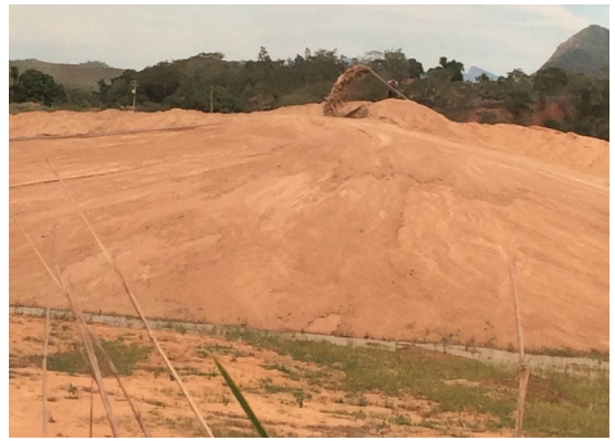
Fot. 6 - Extração de areia no rio Muriaé (área rural de Cardoso Moreira) (Fotografia de Claudio Henrique Reis , abril de 2015).
