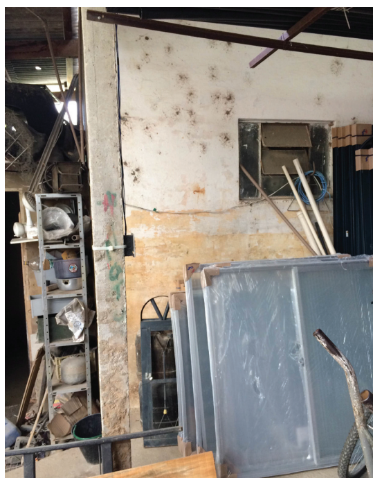
Fot. 2 - Marcas da inundação de janeiro/2012 em uma loja de material de construção na cidade de Cardoso Moreira (Fotografia de Cármen Ferreira, abril de 2015).
