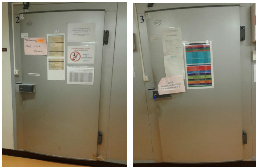
Figura 1: Frigoríficos do armazém (à esquerda – frigorífico aberto – e à direita – frigorífico de acesso restrito a farmacêuticos).
