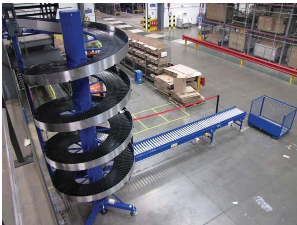
Figura 2-5 – Exemplo de um transportador em espiral da AmbaFlex instalado e preparado para funcionar.
