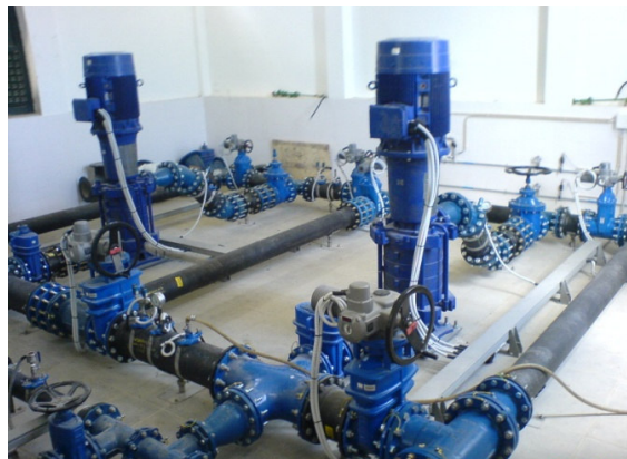
Figura 8.17 – Grupos eletrobomba da “Sobrepessora de Valença” (Fonte: AdNORTE).
