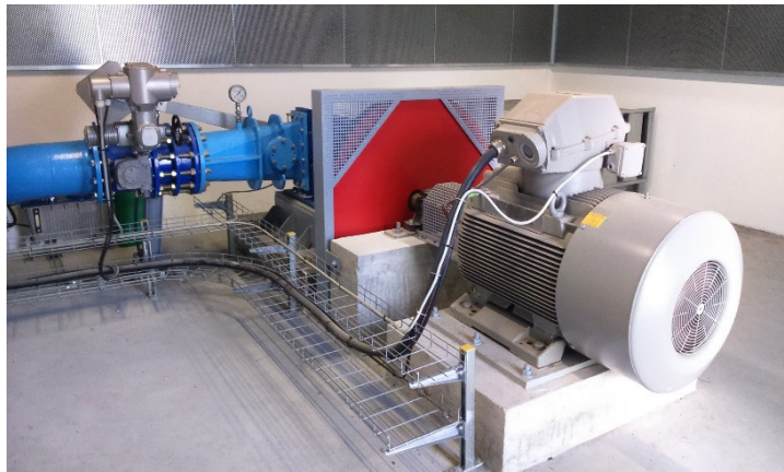
Figura 1.2 – Aproveitamento hidroelétrico de Beiriz, na Póvoa de Varzim – instalação de recuperação da energia hídrica num sistema de abastecimento de água (Fonte: AdNORTE).
