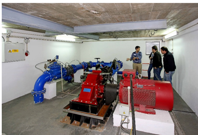
Figura 2.2 – Instalação de abastecimento de água (Águas da Região de Aveiro, S.A.) de recuperação de energia, com turbina Cross-flow (foto gentilmente cedida pela FotoEngenho).
