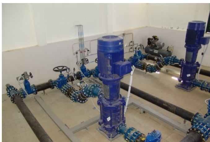
Grupos eletrobomba da Sobrepessora de Valença.
