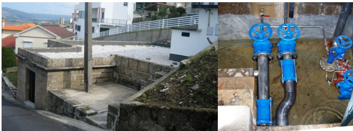
Figura 8.21 – Panorâmica lateral e do interior (câmara de manobras – válvula de controlo altimétrico) do Reservatório da Vila de Vila Nova de Cerveira (Fonte: AdNORTE).
