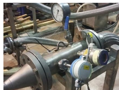
Figura 2.11 - Acessório onde estão alocados os medidores de temperatura e pressão
