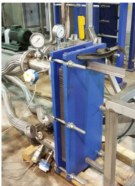
Figura 3.1 - Permutador ASPTH na zona de teste do permutador
