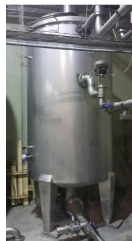
Figura 2.13 - Tanque de armazenamento de água fria
