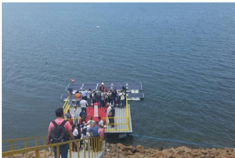
Figura 4-Painéis solares na Hidroelétrica de Balbina (Paiva 2016)
