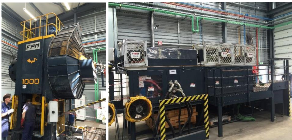
Figura 146 Principais equipamentos instalados na empresa para o processo de forjamento: Prensa Mecânica excêntrica (à esquerda); Forno de Indução (à direita).
