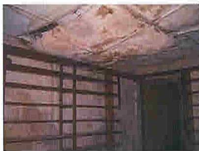
15- Vista do 1º Andar – Manchas de humidade
