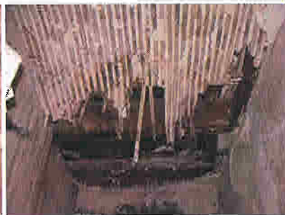
19- Vista do 2º Andar – O tecto está a cair
