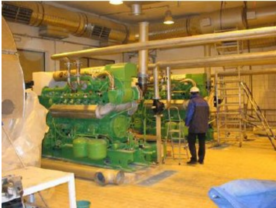
a) Instalação de cogeração da ETAR de Kapusciska, Polónia (Norli, 2006)
