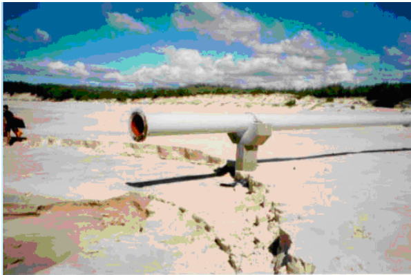
Figura A1.3 – Tubagem de descarga (2002)
